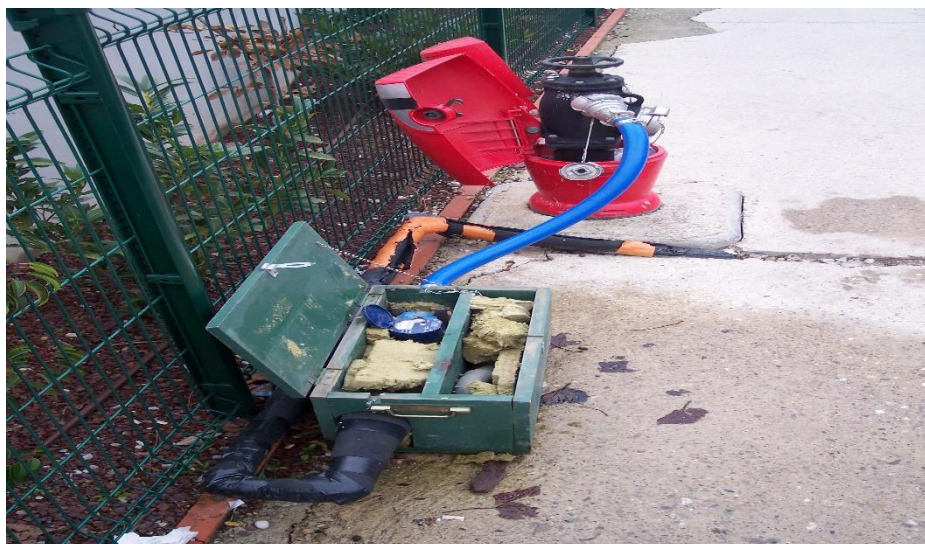
Figure 41 : Compteur provisoire raccordé à une borne d'incendie pour alimenter un chantier de construction
