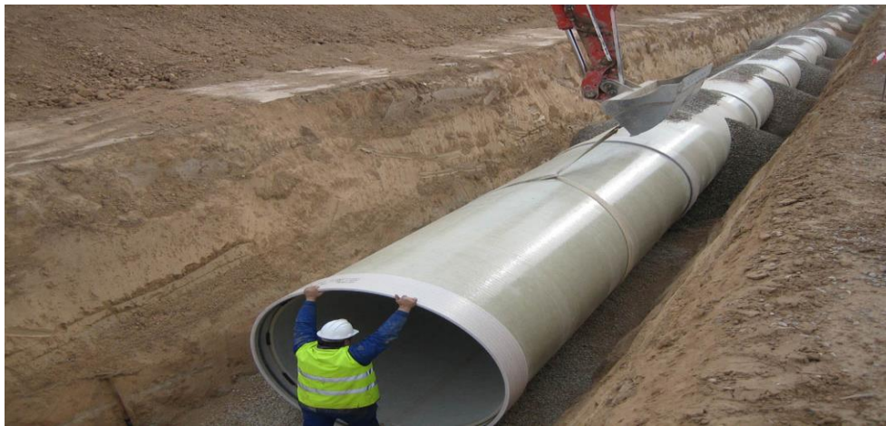
Figure 9 : Tuyau en PRV
